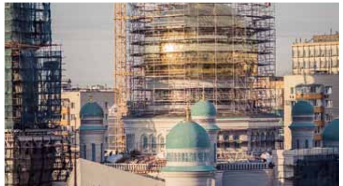
Крепление наружной и внутренней облицовки: 2500 тонн сложных декоративных изделий из гранита (Московская Соборная Мечеть, г. Москва, 2015 г.)
