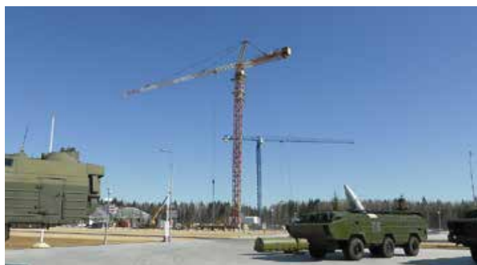
Монтаж башенных кранов и металлоконструкций к железобетонным фундаментам на объектах специального назначения (РФ, 2016 г.)
